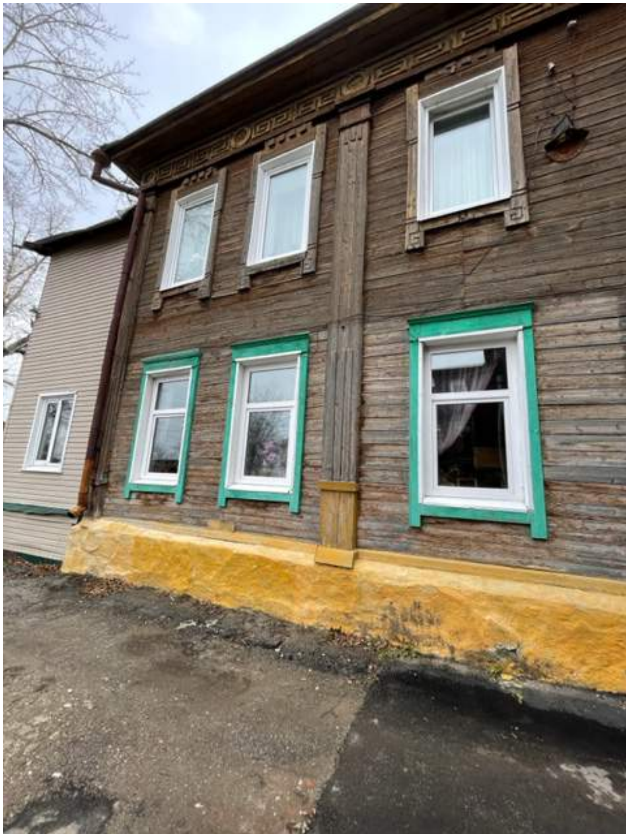
Фото 10. Фрагмент западного фасада. Эксперт Беляева Е. Э. 14.11.2023 г.
