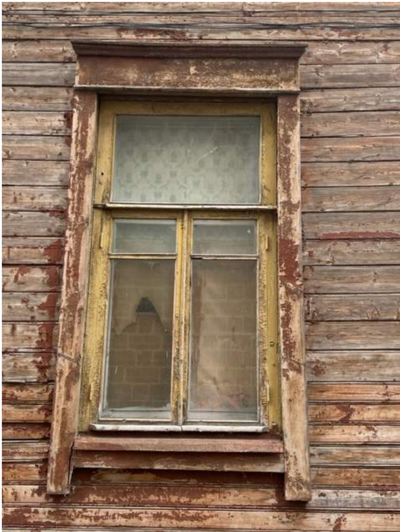
Фото 11. Фрагмент западного фасада. Эксперт Беляева Е. Э. 14.11.2023 г.
