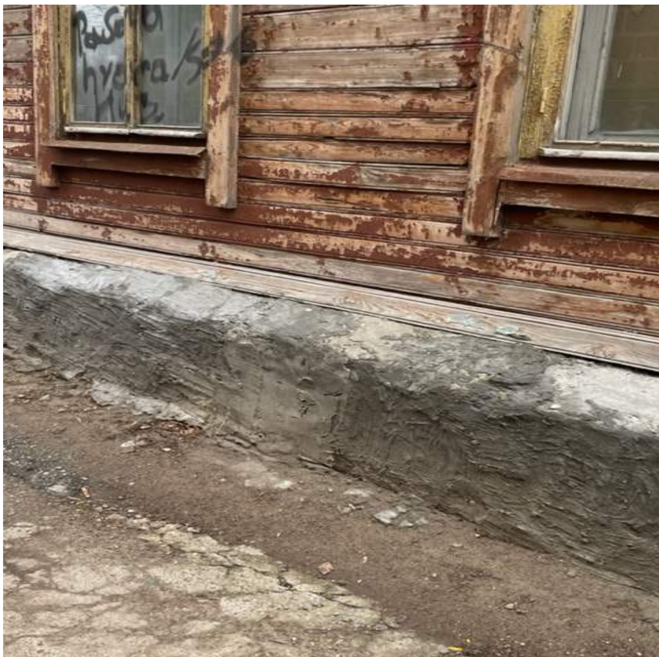
Фото 13. Фрагмент западного фасада. Эксперт Беляева Е. Э. 14.11.2023 г.
