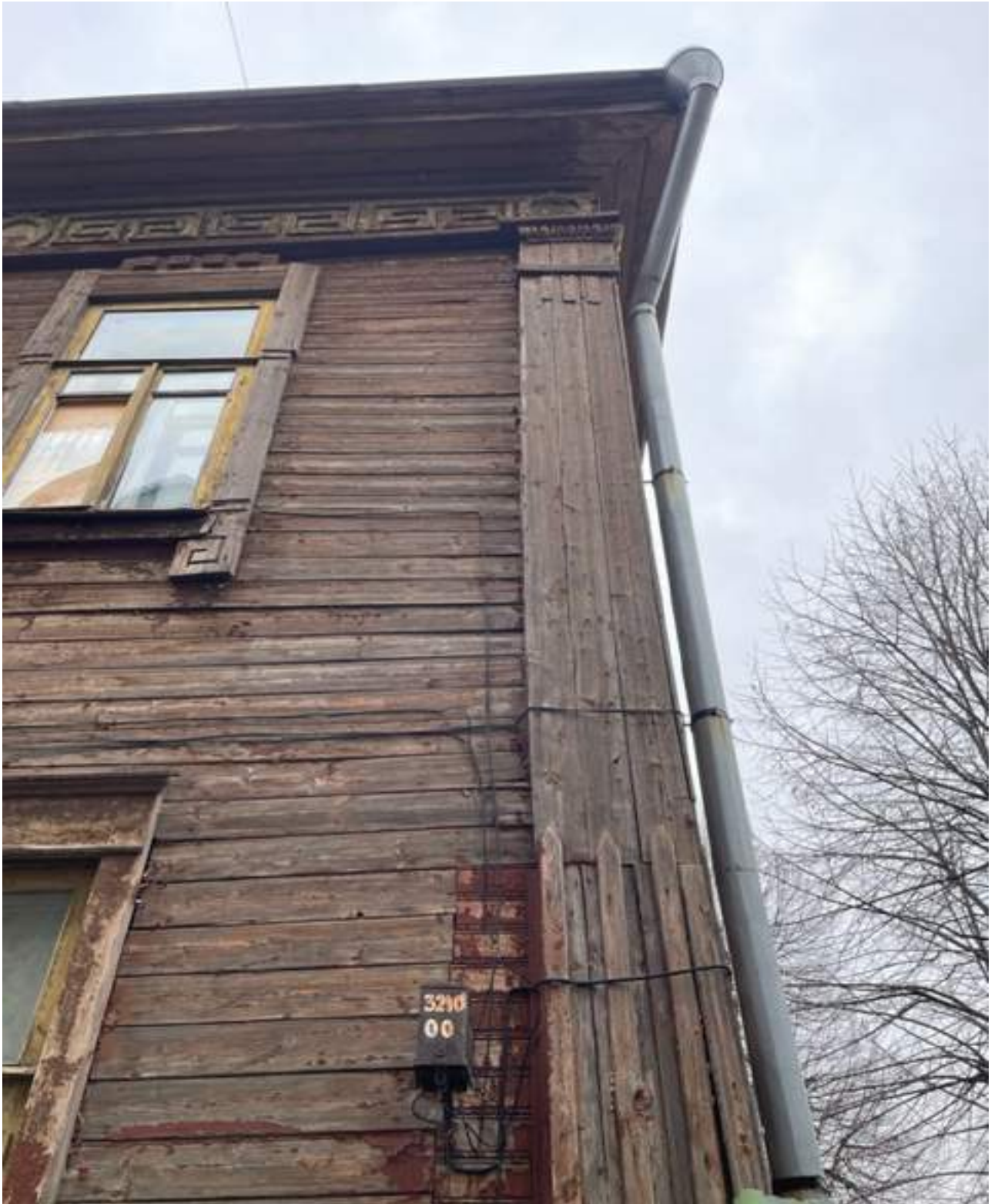
Фото 12. Фрагмент западного фасада. Эксперт Беляева Е. Э. 14.11.2023 г.
