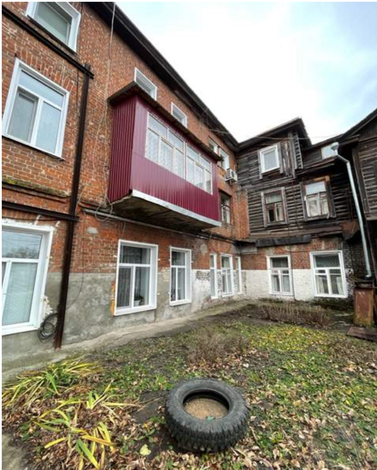
Фото 3. Северный фасад основного объема. Фрагмент восточного фасада дворовой части здания. Эксперт Беляева Е. Э. 14.11.2023 г.
